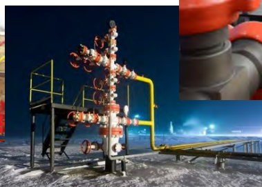
Устьевая арматура скважин
